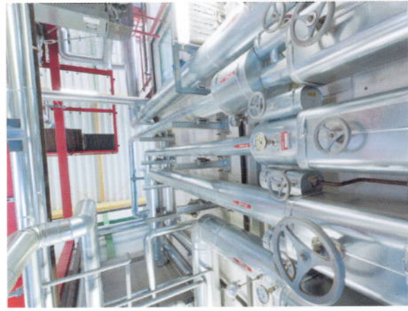
Blick in ein Biomasse-Heizkraftwerk: Innovative Technik macht Energieerzeugung mit biogenen Reststoffen hocheffizient.
